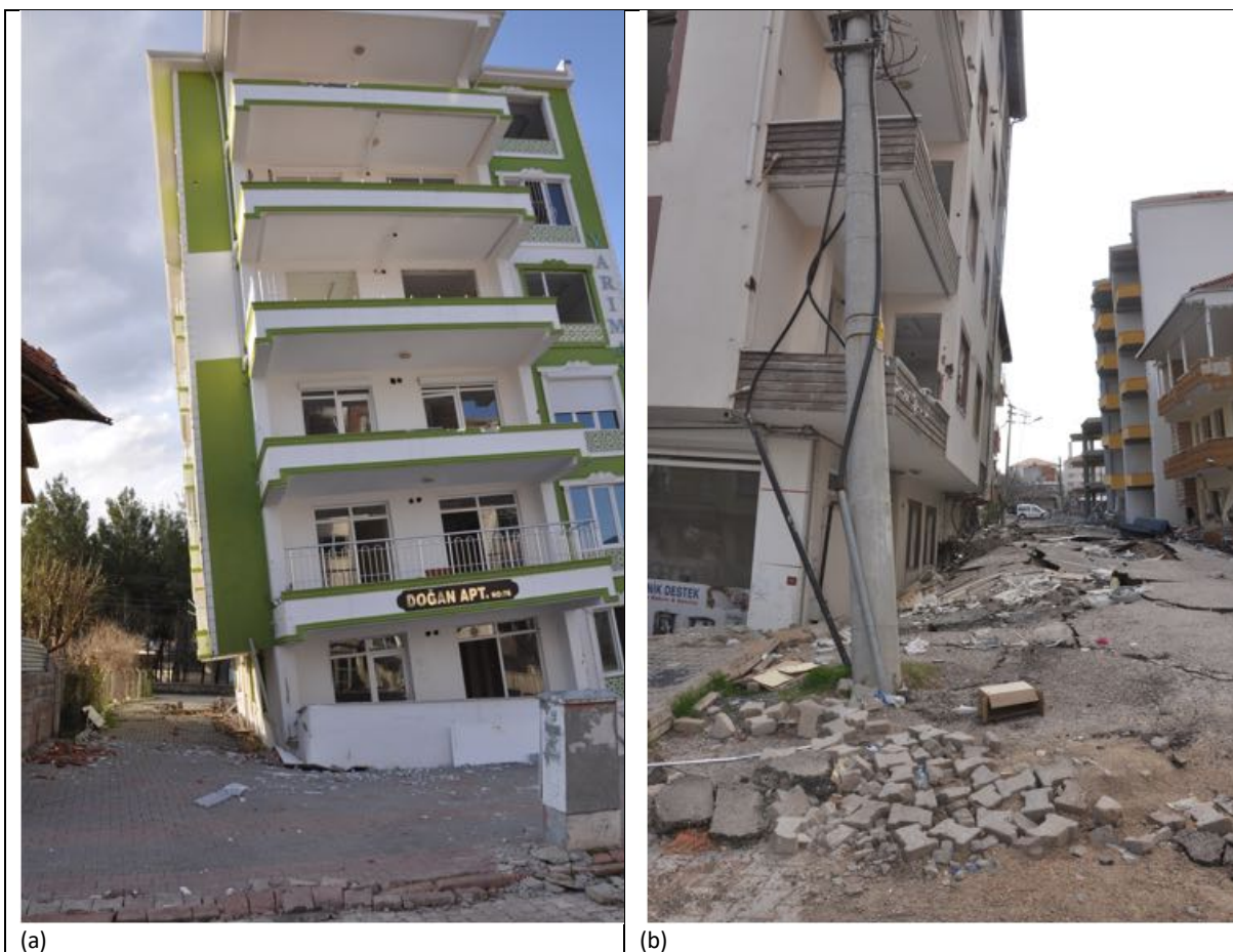
Figura 4. Gölbaşı: (a) Cinematismo di edificio alto su piastra di fondazione per effetto della liquefazione; (b) Sconfigurazione del piano stradale
