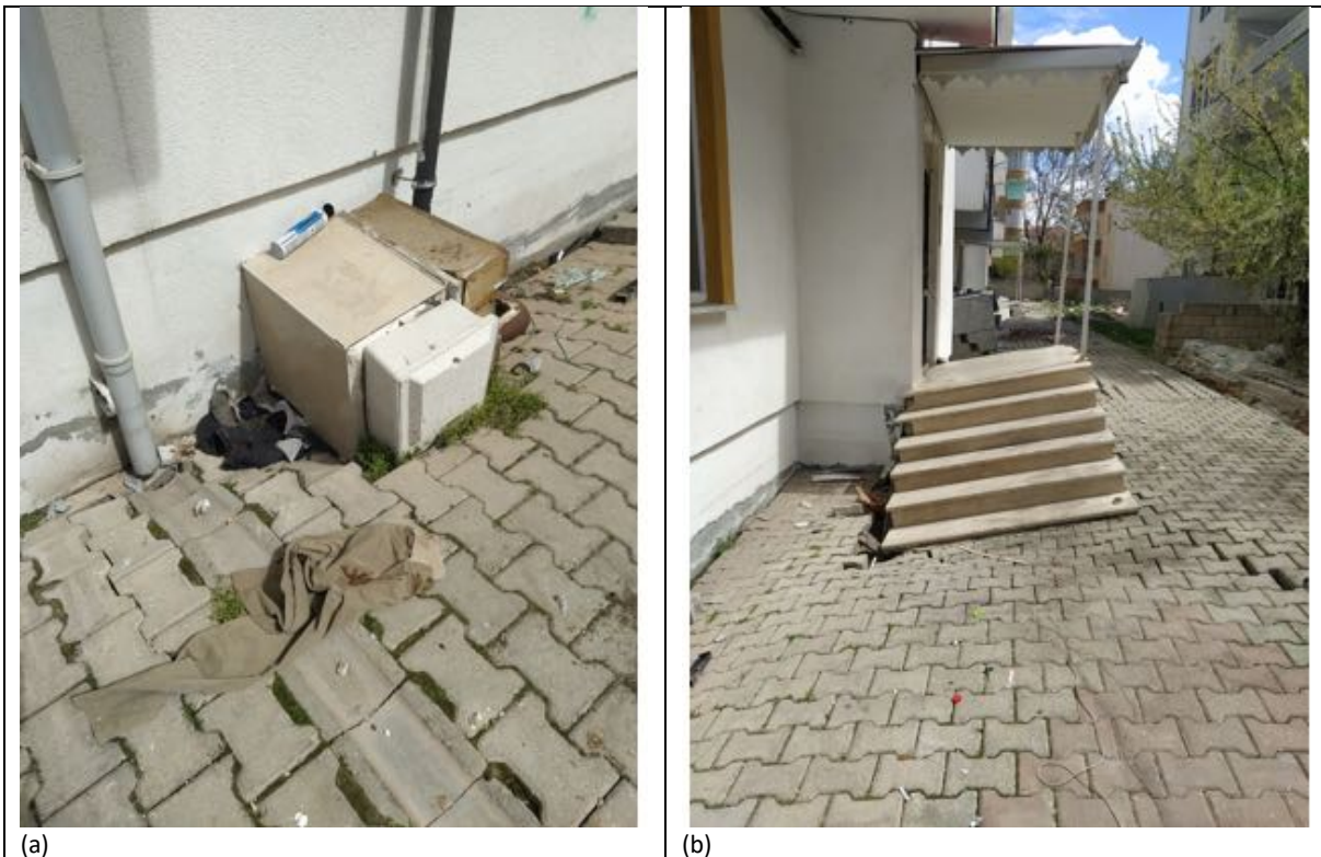
Figura 5. Gölbaşı: Effetti della liquefazione su (a) impiantistica; (b) accessibilità
